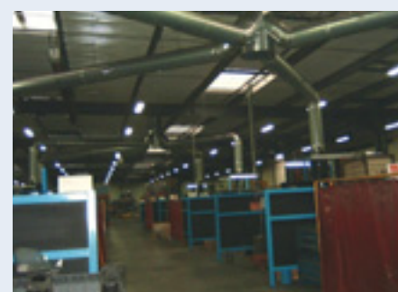
Fig. 34. Vue générale de l'installation.
